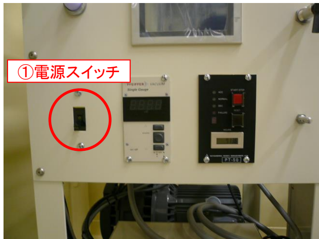
図 真空ポンプ(実験ハッチ内)
